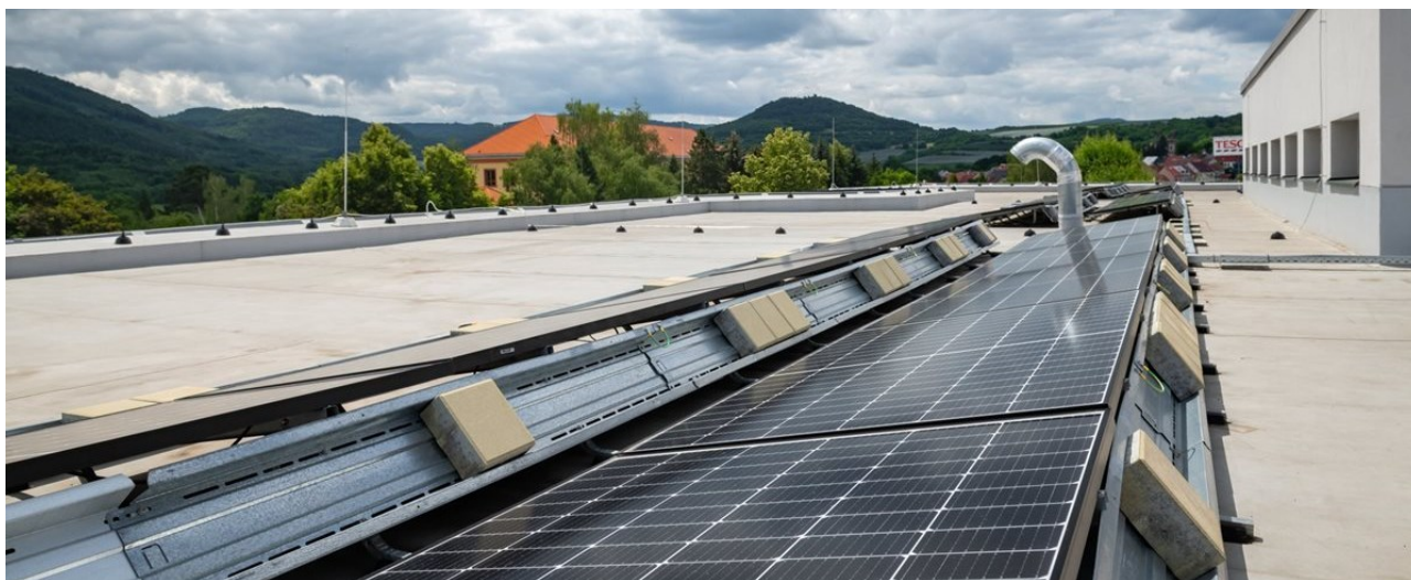
Obr. 79: Strešná fotovoltaická elektrárň (KC Klášterec nad Ohří), zdroj: Adapterra Awards - Nadace Partnerství (Vojta Herout)
