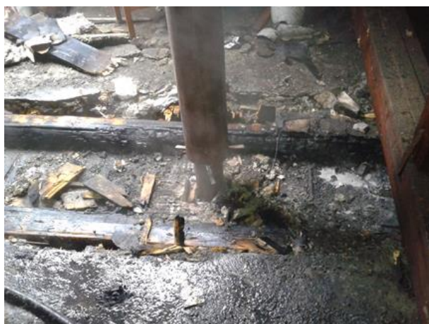
Nesprávne vyhotovený komín v mieste prechodu cez stavebnú konštrukciu
