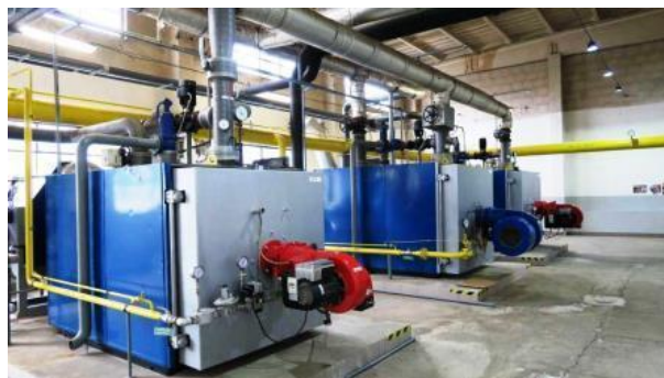
Strojovňa kotolne – kotly
