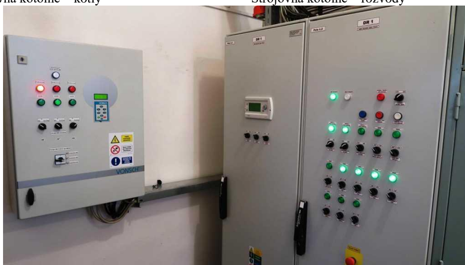
Riadiaci systém SIEMENS SX
