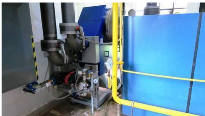
Kotel K3 s doinštalovaným termokondenzátorom
