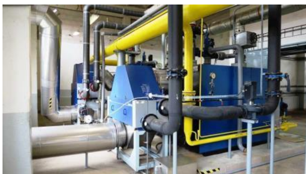
Nainštalované termokondenzátory na kotloch K2 a K3
