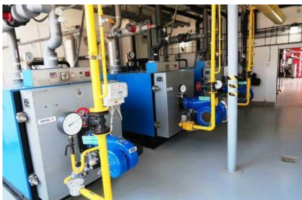
Strojovňa kotolne – kotly
