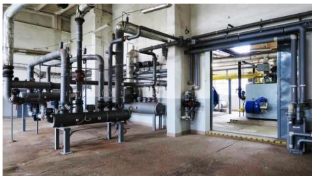
Strojovňa kotolne - rozvody
