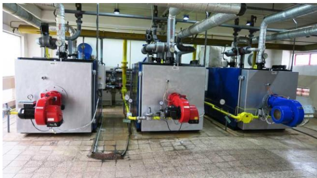
Strojovňa kotolne – kotly
