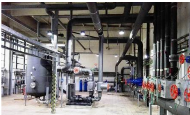
Strojovňa kotolne – rozvody
