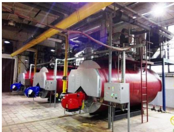
Nainštalované kotly VHP
