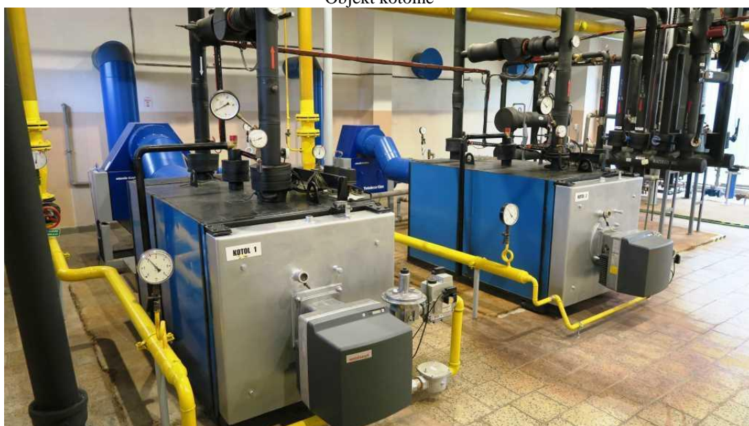
Strojovňa kotolne – kotly s doinštalovanými termokondenzátormi.
