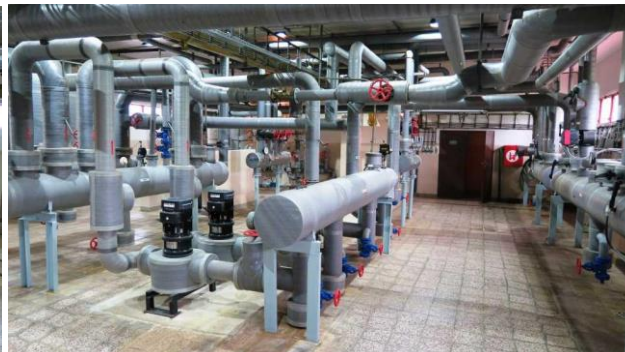
Strojovňa kotolne – rozvody
