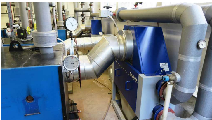
Termokondenzátory na K1 a K3
