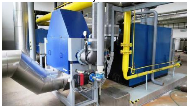
Kotly s doinštalovanými termokondenzátormi
