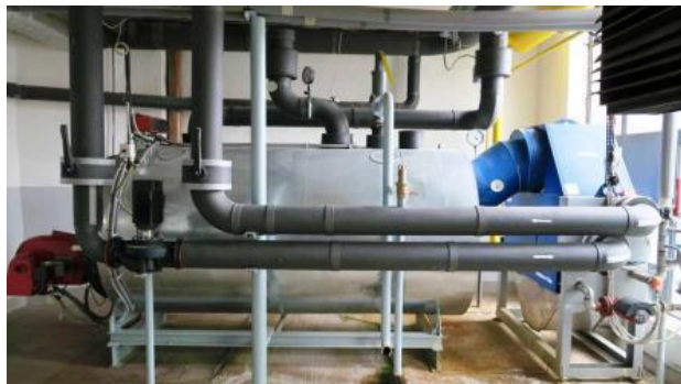
Kotel K1 s doinštalovaným termokondenzátorom
