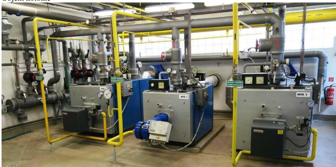
Strojovňa kotolne – kotly s doinštalovanými termokondenzátormi.
