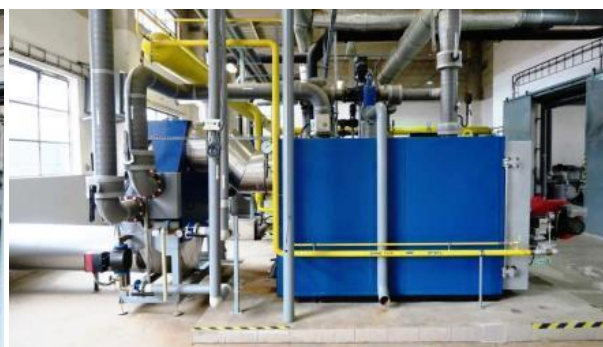
Kotol K1 s termokondenzátorom
