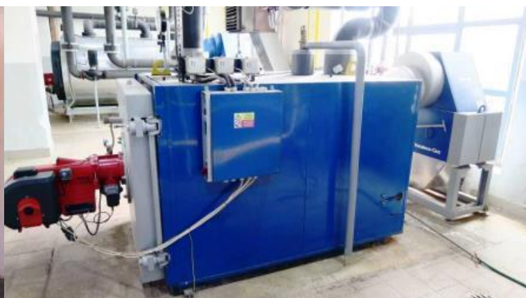
Kotel K2 s doinštalovaným termokondenzátorom
